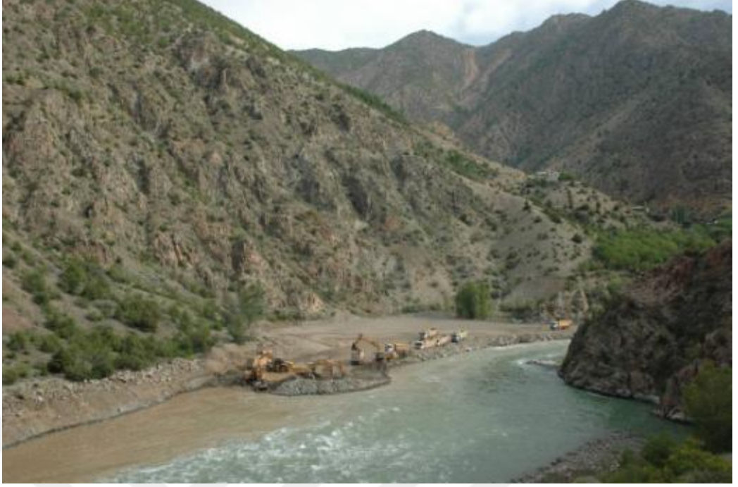
Şekil 51. Verçenik Dağı YHGS - İnşaat Çalışmalarının Yaban Keçisi Habitat Kullanımına Etkileri (Taşlıca Mevkii)
