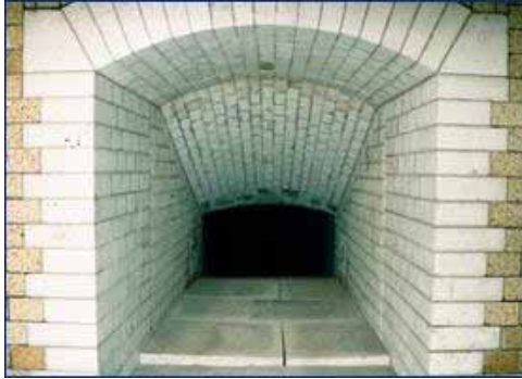
Şekil 1.16. Rejeneratörden fırına geçiş bölgesi -Portlar (Eriyik mullit tuğla kullanımı).
