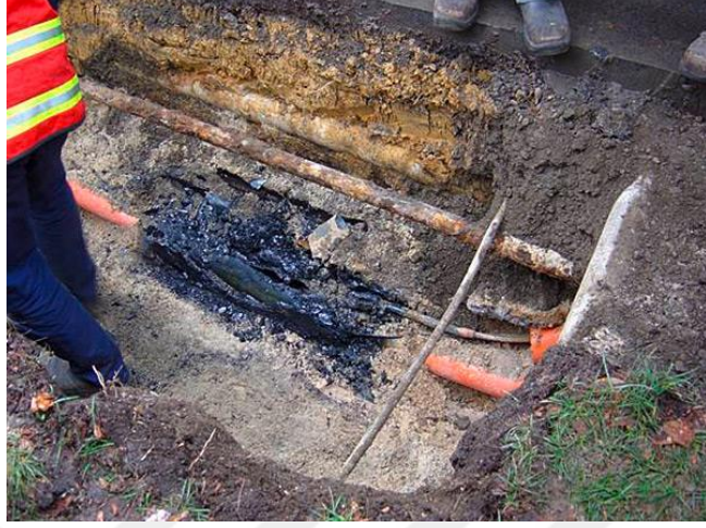
Görsel 5.2. Bir yer altı kablo arızası
