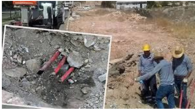
Görsel 5.11. Kazı çalışması nedeniyle yer altı enerji hattına verilen bir hasar
