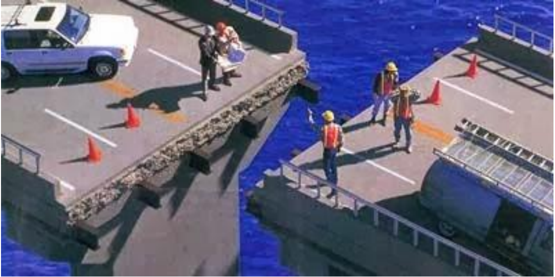
Görsel 2.1. İnşaat yapım işi hatası (http-1)
