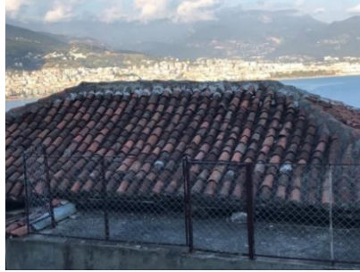
Resim 4.22. Rengi deforme olmuş alaturka kiremitli çatı
