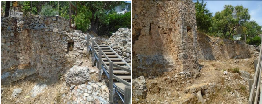
Görsel 3.39. Tophane Mahallesi 423 ada 1 parsel drenaj ağzı (Akman, N.)
