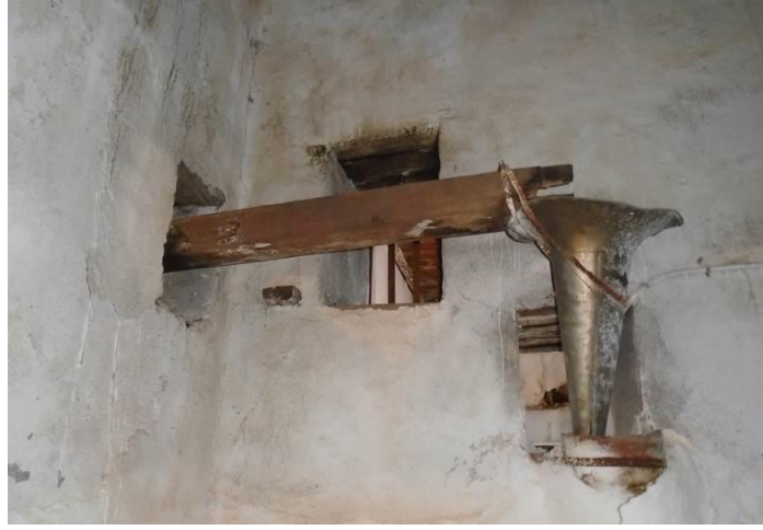
Görsel 3.47. Çatı yağmur suyu sisteminin sarniç bağlantısı (Akman, N.) Çatıda oluşturulan sistem ile su, yağmur mevsiminde sarniçlarda depolanır (Bkz. Görsel 3.48).
