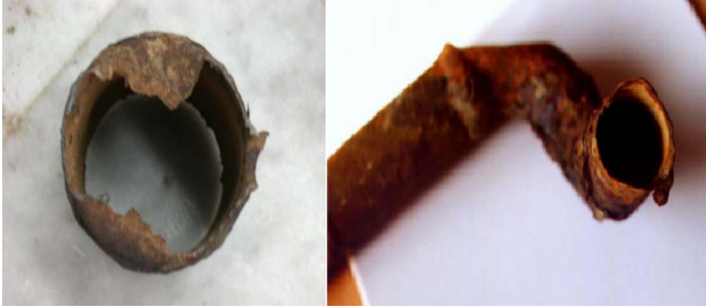
Şekil 2.29 Homojen korozyon sonucu kopan doğalgaz boruları örnekleri
