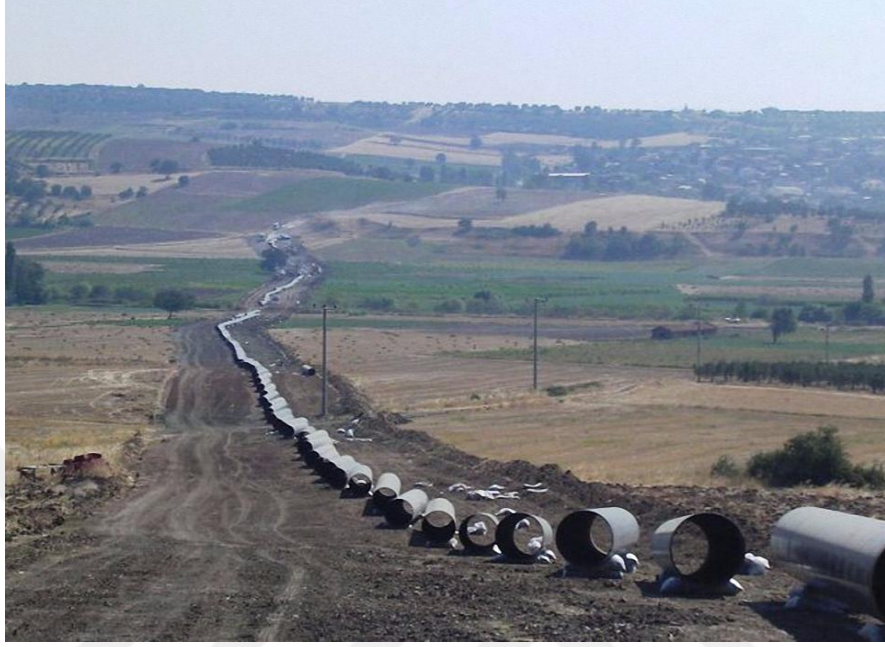
Şekil 3.10 Dış akım kaynaklı katodik koruma uygulaması yapılması planlanan boru hattı
