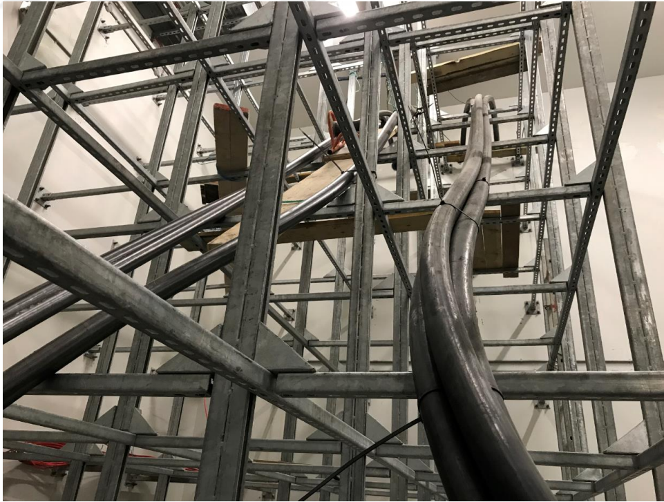
Şekil 6.6: Kablo tünelineki yüksek gerilim kablolarının çıkışı.
