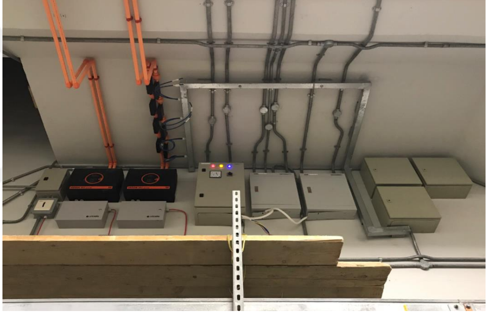
Şekil 6.18: Kablo tünelinin yangın, ısı ve haberleşme panelleri.
