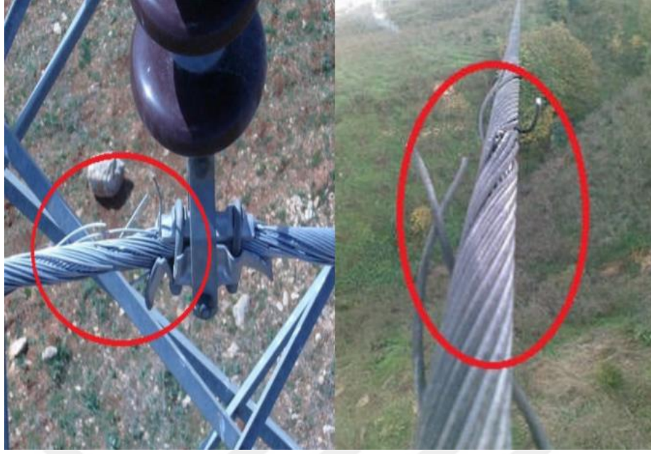
Şekil 2.3: Havai iletim hatlarında tellerde kopukluk hadisesi.
