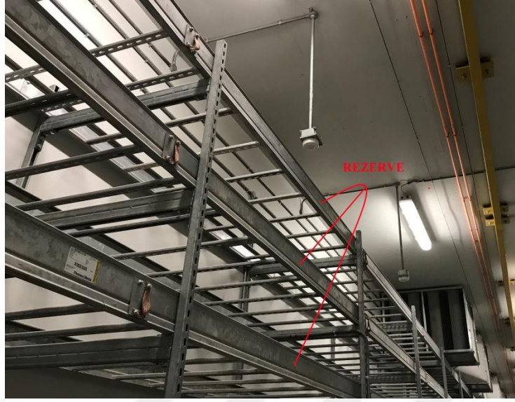
Şekil 6.2: Rezerv olarak ayrılan kablo merdivenleri.
