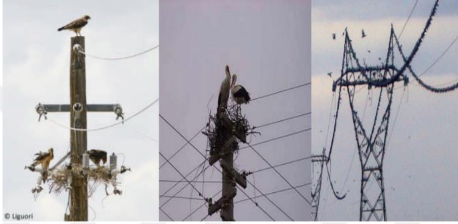
Şekil 2.6: Kuşların vermiş olduğu zararlara maruz kalan havai hatlar.
