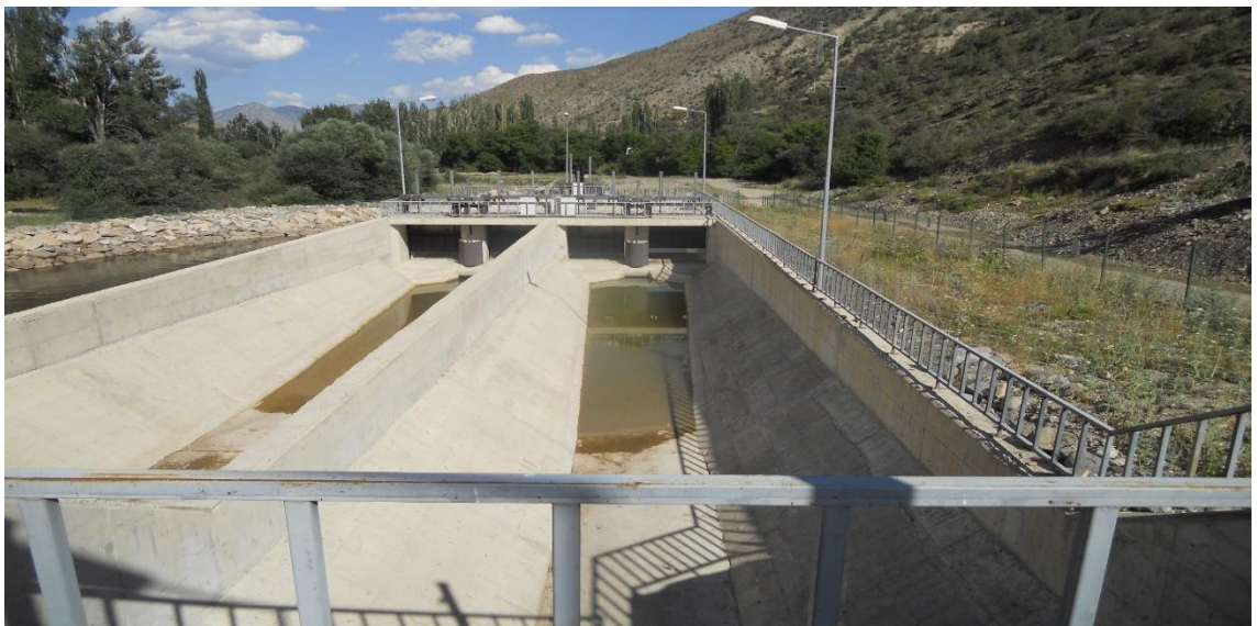
Fotoğra 4.8. Bağbaşı HES Çökeltme Havuzu
