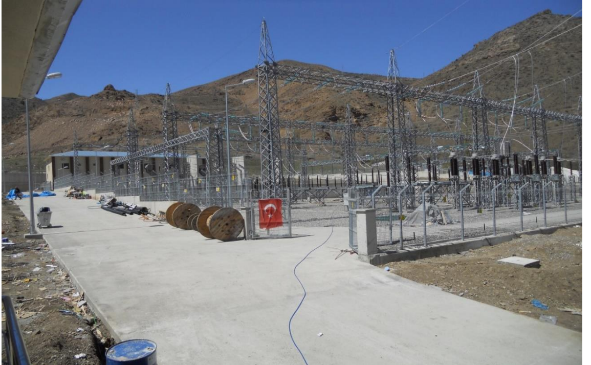
Fotoğraf 4.13. Elif Havza Trafo Merkezi
