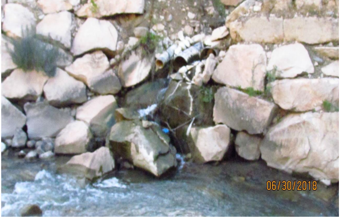
Fotoğraf 5.11. Katıklı Çayına Bağlanan Kanalizasyon Hatlarının Oluşturduğu Kirlilik.
