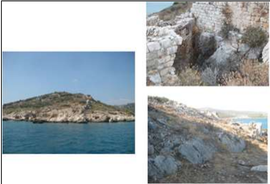
Resim 5.1. Yapı duvarlarının oturduğu doğal kayalık alanda/temelde aşınma, kayıp, yarıklar
