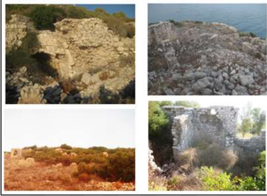
Resim 5.7. Özgün yapıya risk oluşturan sorunlar
