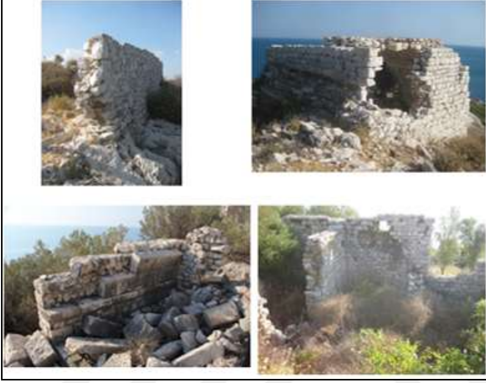
Resim 5.2. Örgüde birim malzeme kayıpları
