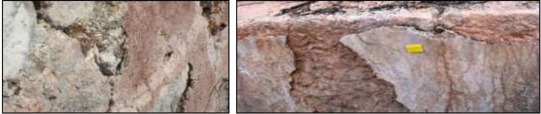
Resim 5.5. Malzeme ufalanma, yarık ve çatlak
