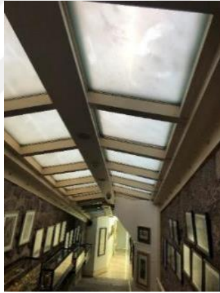
Resim 8.10. Geçiş bölümünün aydınlatılması (2018)
