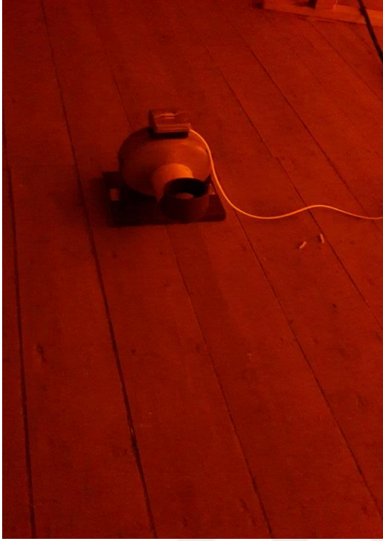
Resim 5.193. Fumigant deşarjı ve havalandırma
