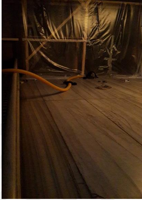
Resim 5.194. Fumigant deşarjı ve havalandırma
