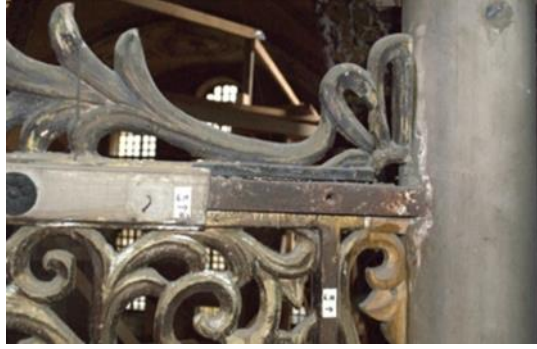
Resim 5.35. 6Nolu şebeke (örnek 6.15) korozyon
