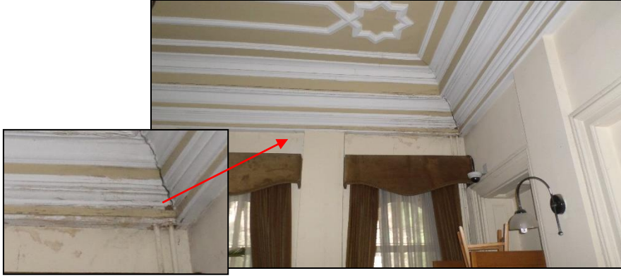
Resim 5.32. Tavan silmesindeki ıslaklık
