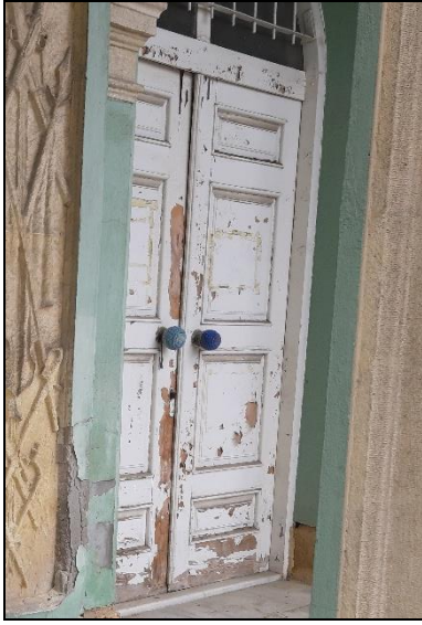
Resim 5.41. Ahşap yüzeylerde boya dökülmeleri
