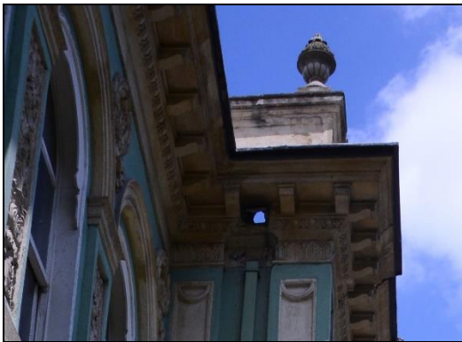
Resim 5.35. Tahliye sistemindeki arızalar
