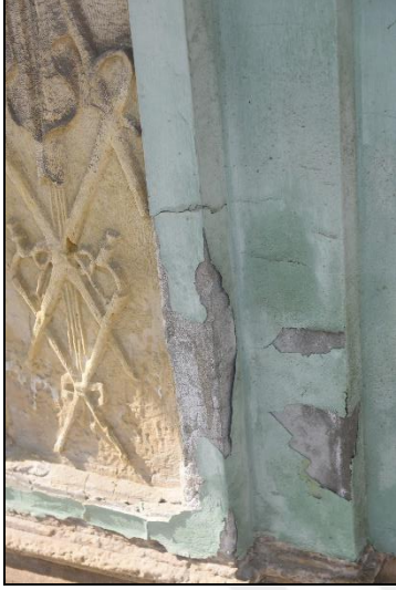
Resim 4.6. Dökülen boyalı kısımlarda tespit edilen çimento sıva
