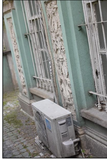
Resim 4.15. Klima dış ünitesi
