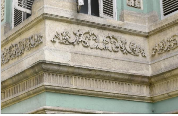
Resim 4.7. Kat silmesi hatalı onarımları
