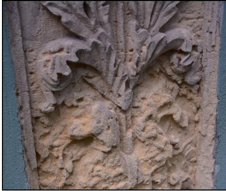
Resim 4.3. Zemin kat cephe süslemelerindeki yüzey kayıpları
