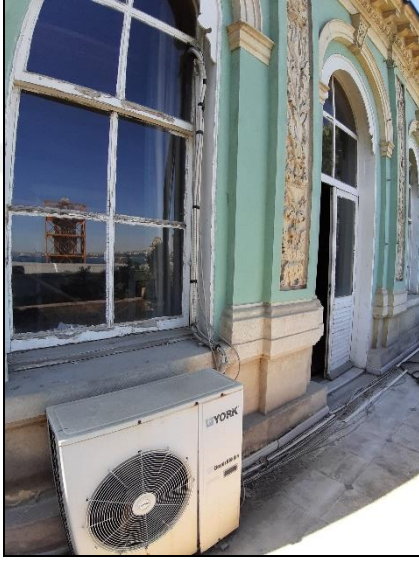
Resim 5.27. Klima ünitesi ve kabloları
