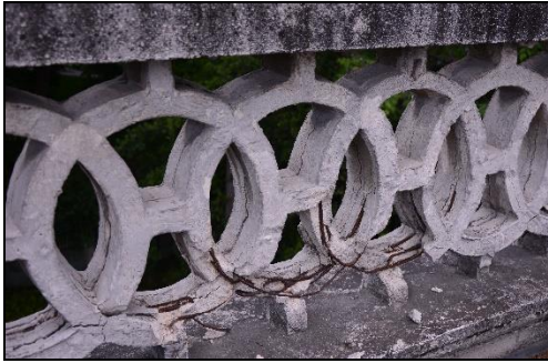
Resim 4.4. Çatı korkuluğundaki donatıların paslanmasından kaynaklı tahribat
