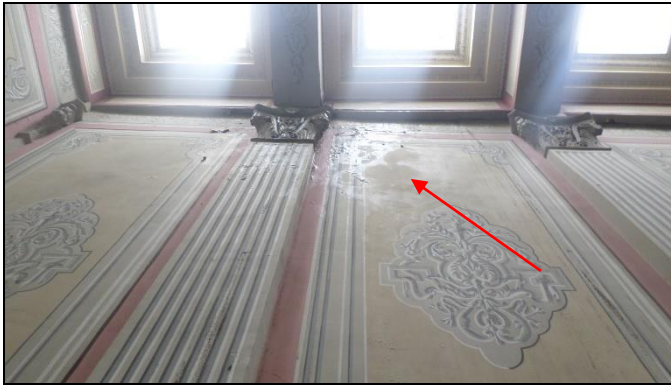
Resim 5.31. Yüzeyde görülen ıslaklık
