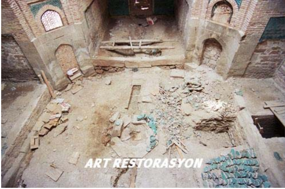
Fotoğraf 21: Konya Sahipata Hanikah-1, 2006, onarım öncesi
