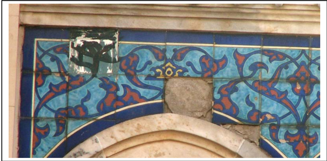
Fotograf 8: Milli Kütüphane Binası, giriş kapısı üstü pencere alınlığı eksik çini karolu pano detayı
