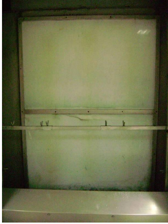
Resim 35- Eleği Yıkama Ünitesi
