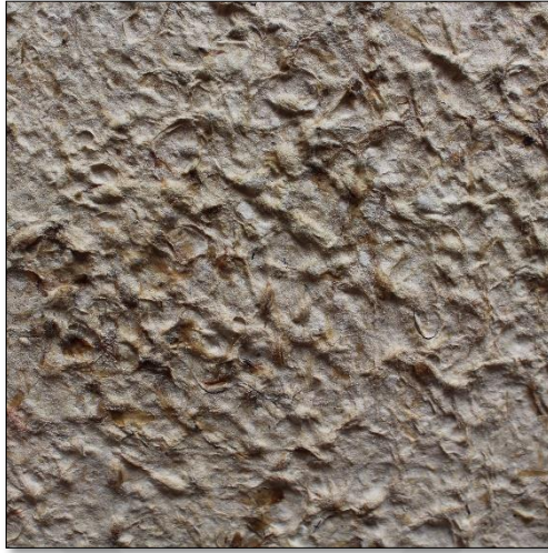
Şekil 78- Kompozit Uygulama: 17-a
