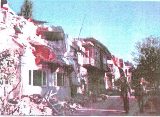
Foto 1: Hasarın Çok Olduđu Alüvyal Zeminde Bulunan Yapılar.
