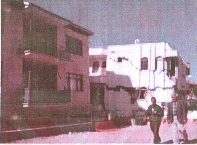
Foto 9: Giriş Katı Yıkılmış Bir Yapı.
