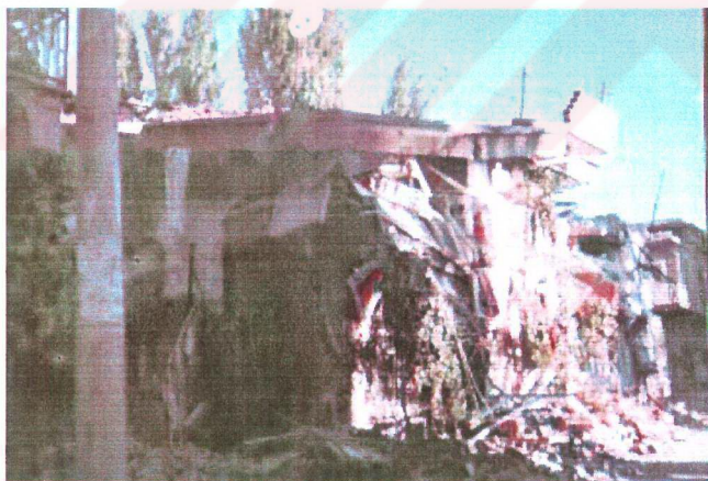
Foto 8: Tavandan Tabana Doğru Yıkılmış Bir Yapı.
