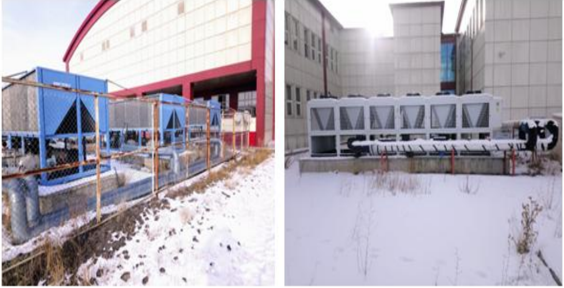
Şekil 3.4: Hastanenin soğutma ihtiyacını karşılayan chiller grubu
