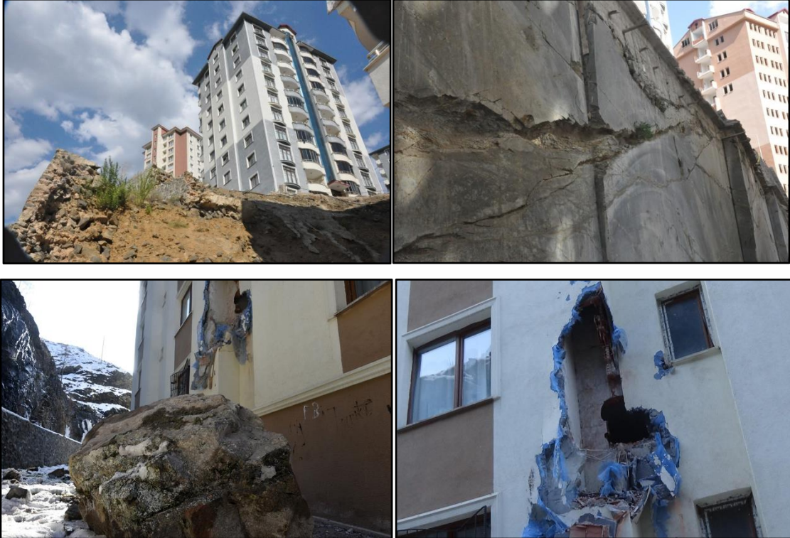
Şekil 3.11. Şev yüzeylerinden kopan andezit blokları (Oltanbey Mah. Aydınlık Evler ve Müze Evler Siteleri)
