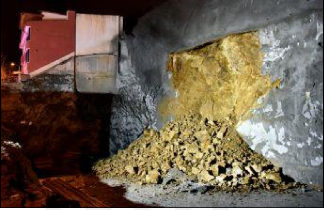
Şekil 3.14. Kesilmiş şevden kopan granit blokları (Karşyaka Mahallesi)
