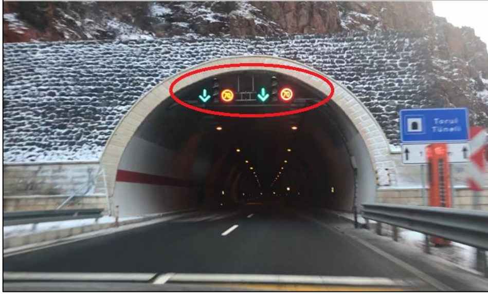
Şekil 1.13. Tünel kapatma ekipmanları (VTS)
