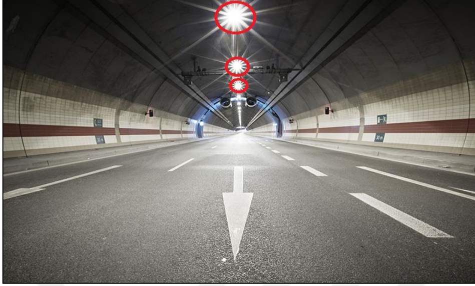
Şekil 1.17. Tünel aydınlatma sistemi (URL-14, 2020).
