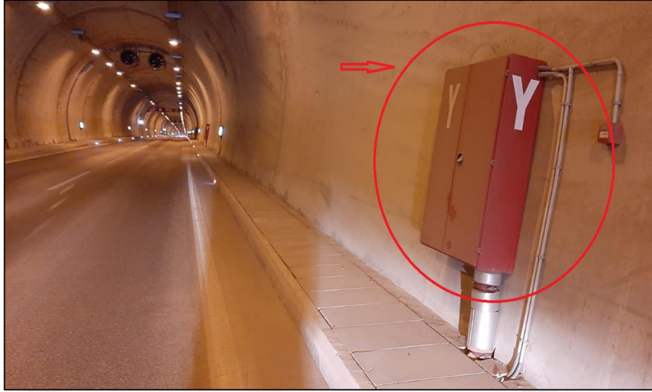
Şekil 1.23. Karayolu tüneline tefriş edilen yangın söndürme dolabı
