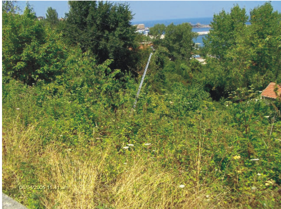
Şekil 5.2 KM1400 kayma alanı içerisinde heyelandan dolayı devrilmiş elektrik direği.
