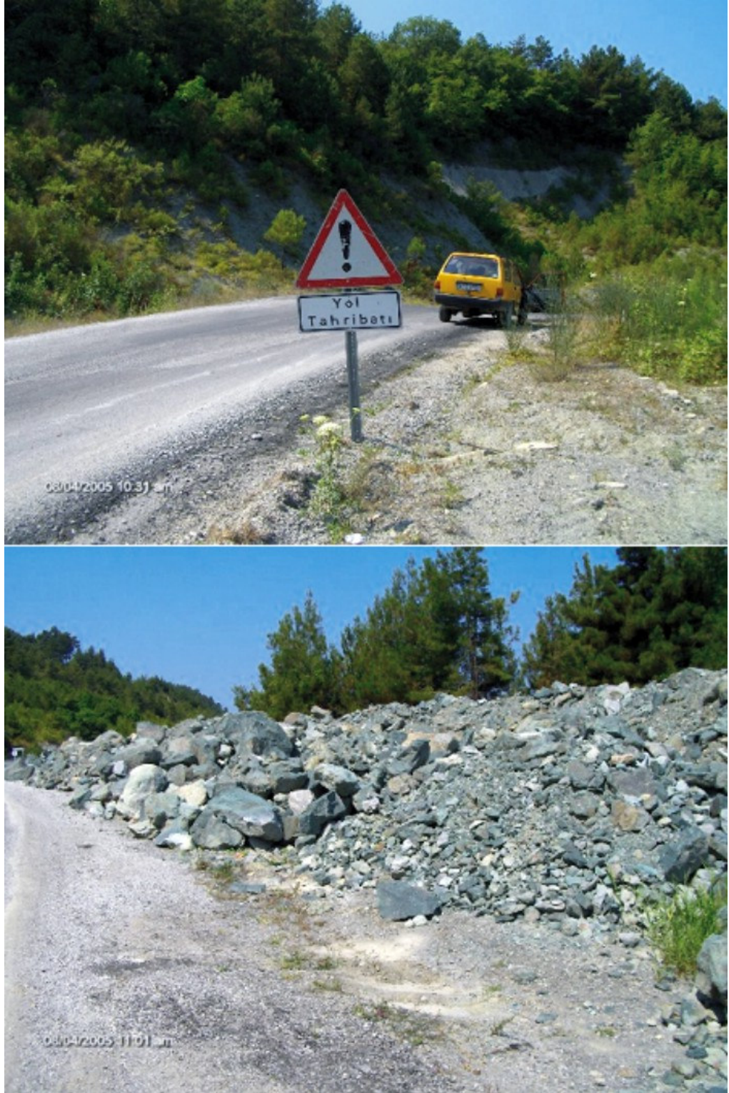
Şekil 6.1 Yolda oluşan tahribatlar ve bu kaymaları önlemek amacıyla Karayollarının kullandığı kaya blokları.
