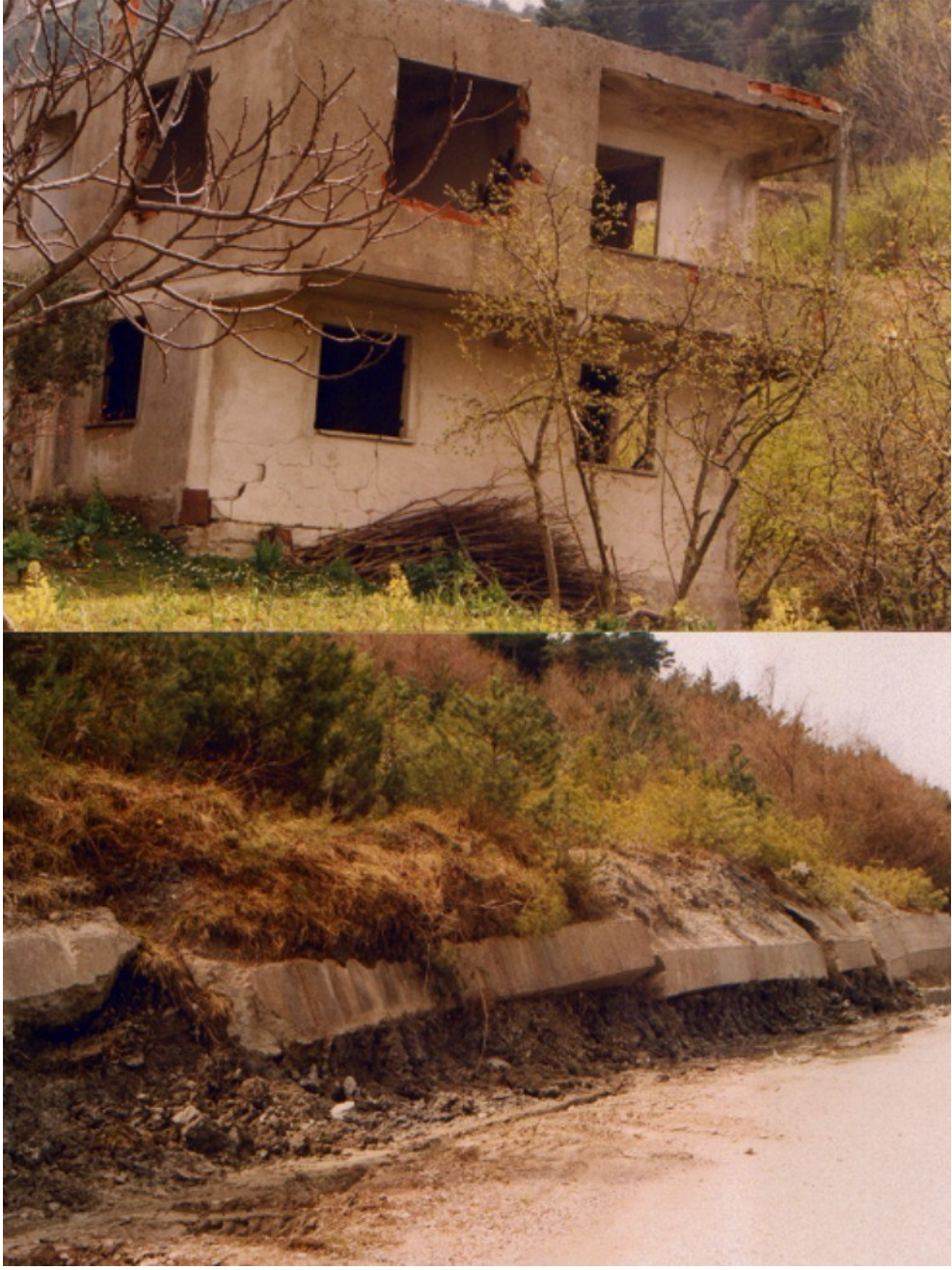
Şekil 6.4 Kayma alanları içinde yapılmış ev ve istinad duvarları.
