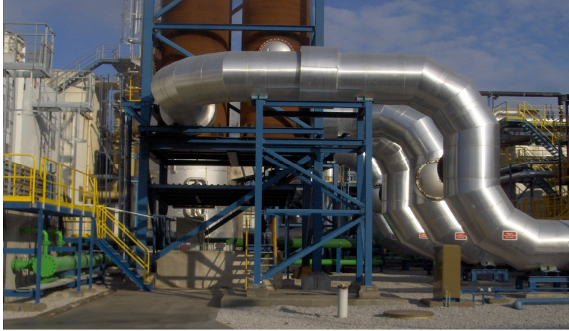
Şekil 1.2 Doğalgaz Dönüşüm Santrali içerisindeki boru sistemleri ve ekipmanlar (Manisa Doğalgaz Enerji Santrali, Girgin,2005).
