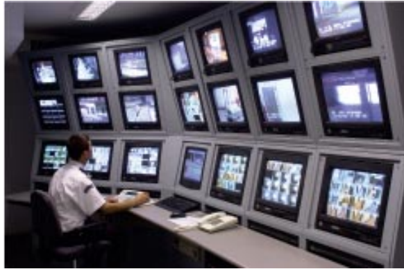
Şekil 4.17 Tekfen Tower CCTV (Kapalı devre izleme sistemi) ve güvenlik kontrol odası.
