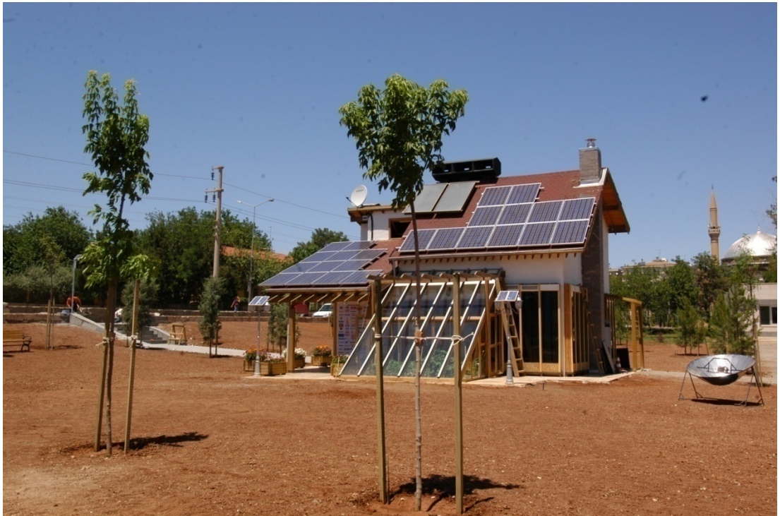
Şekil 4.88 Binanın çatısına konulan fotovoltaikler
