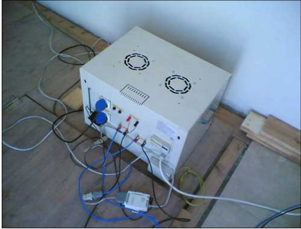
Şekil 5.11 Sismometreyi besleyen kesintisiz güç kaynağı.
