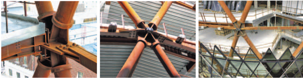
Şekil 4.14 30 St Mary Axe ofis binası diyagonal çelik iskelet sistem yapı taşıyıcı sistem düğüm noktası detay görünümü, (Dominic, 2004)
