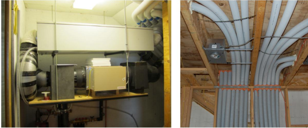
Şekil 4.19 Havalandırma fotoğrafı (Passive House In The Woods, bt)
