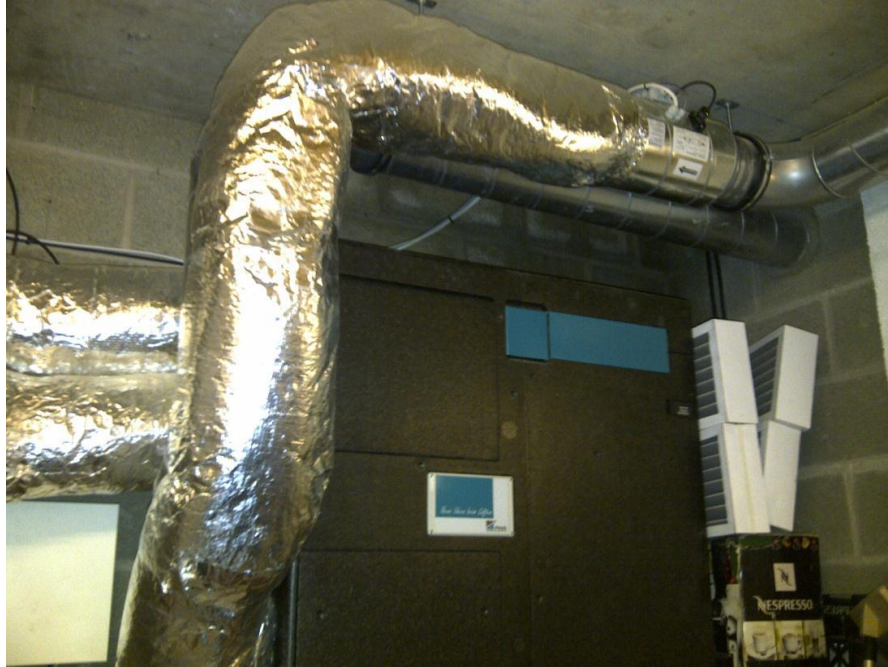
Şekil 4.59 Denby Dale Evi'nde kullanılan MVHR sistemi (Denby Dale Passivhaus, bt)
