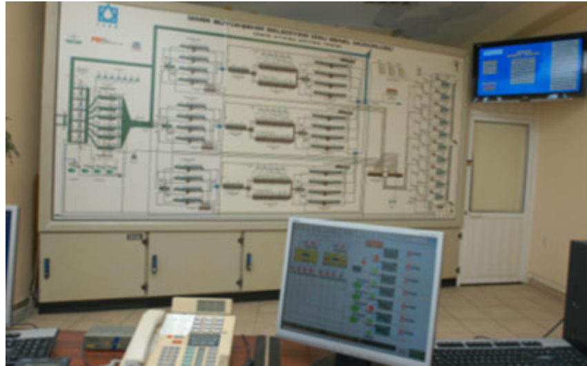
Şekil 1.5 Çiğli atık su arıtma tesisinde otomasyon merkezi (Anonim, 2013b).
