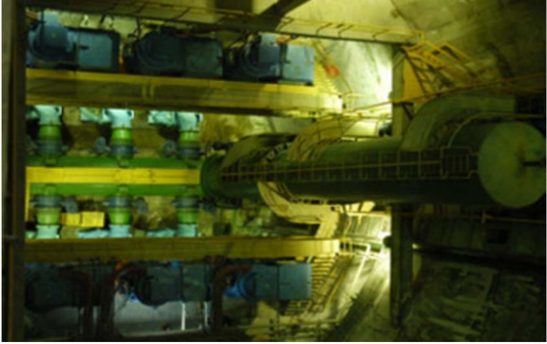
Şekil 4.3 Tahtalı Barajı su alma yapısı içindeki pompa üniteleri
