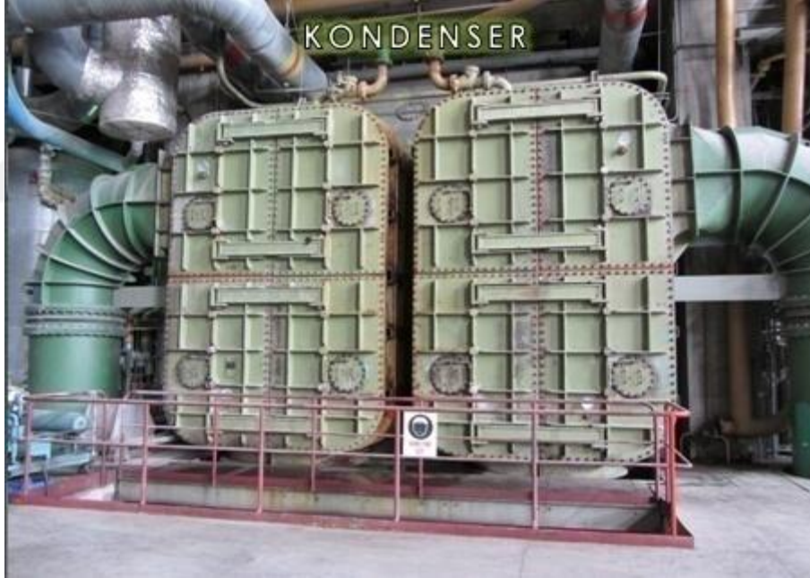
Şekil 3.12 Yoğuşturucu genel görünüşü
