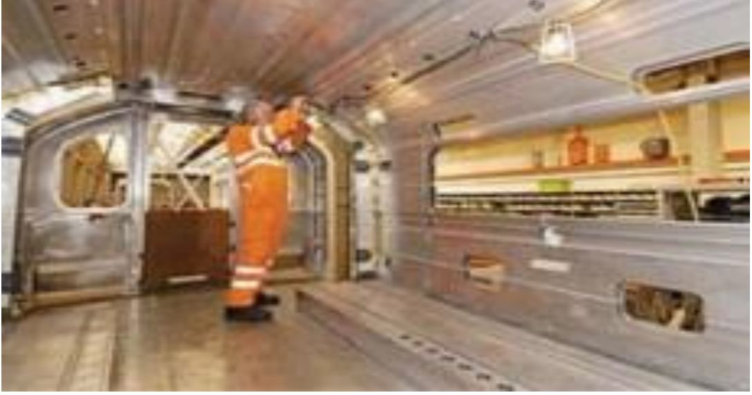
Şekil 2.4 Banliyö treni gövdesinde SKK kullanımı (TWI, bt)
