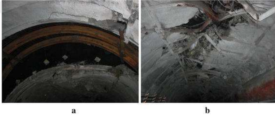
Şekil 2.9 a) Çatı çökmesi. b) Üst kemerde bozulma (Li ve diğer., 2016)
