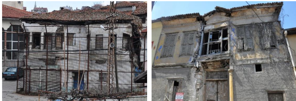
Şekil 5.21 Terk sonrası bakımsız kalarak esaslı onarıma ihtiyaç duyacak hale gelmiş yapılara örnekler (Kişisel arşiv, 2019)
