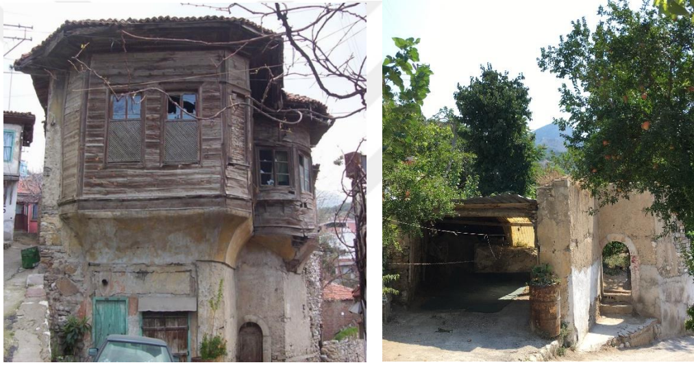
Şekil 5.12 a) Koruma çalışmaları kararının doğru zamanda alınmaması nedeniyle kaybedilen, dokunun en eski yapılarından biri olan 214 Ada 50 parseldeki tescilli yapının yıkılmadan önceki resmi (Soma Belediyesi arşivi, 2010), b) Yapının yıkıldıktan sonraki, günümüz hali (Kişisel arşiv, 2017)
