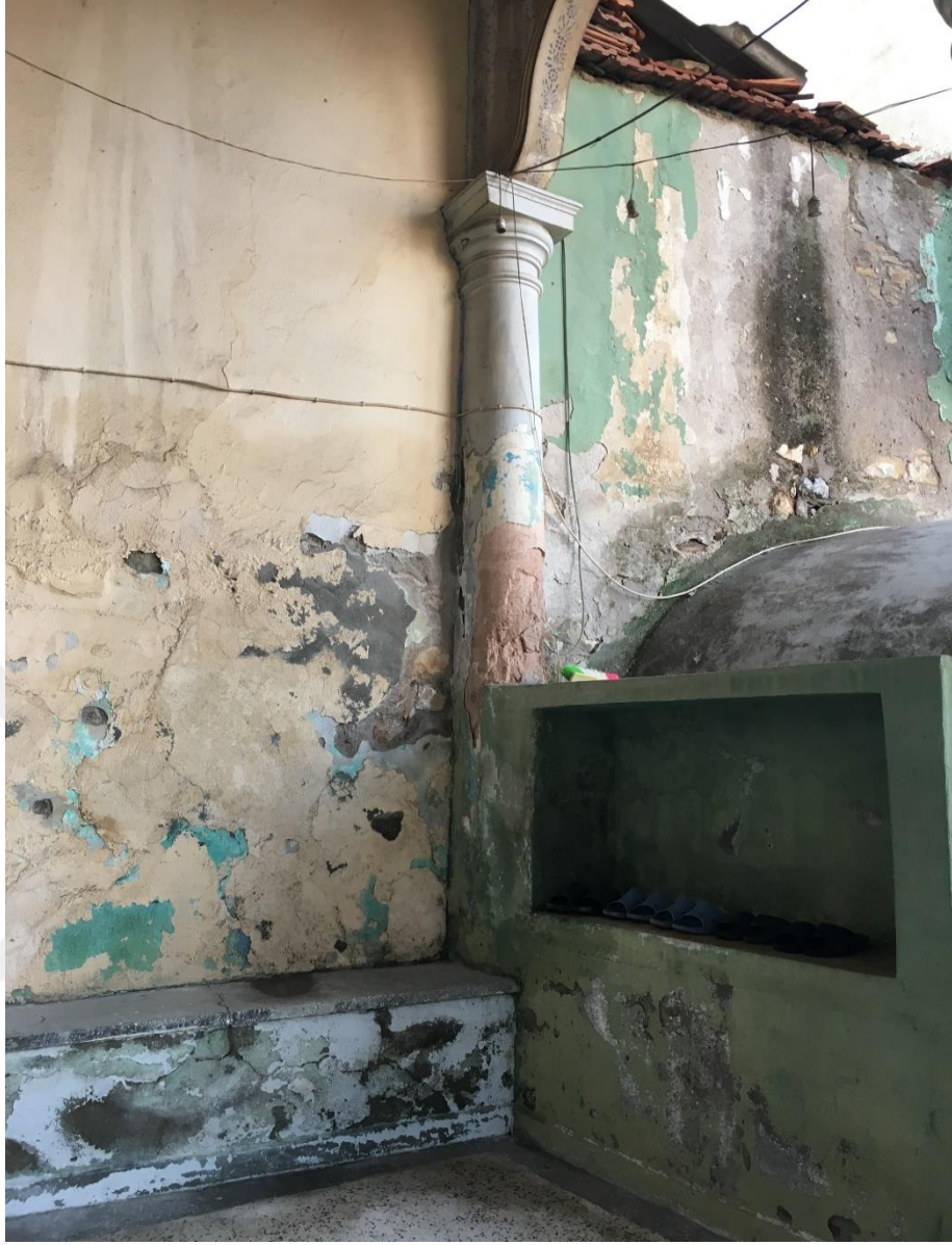
Şekil 2.24 Son cemaat yerinin batı duvarındaki malzeme bozulmaları gösteren görüntü (Kişisel arşiv, 2017)
