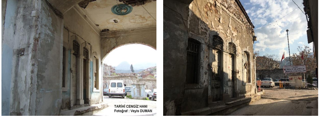
Şekil 5.9 a) Hanın giriş kısmındaki tavanın yıkılmadan önceki hali (Soma Belediyesi, b.t.), b) Yıkıldıktan sonraki, günümüz hali (Kişisel arşiv, 2017)
