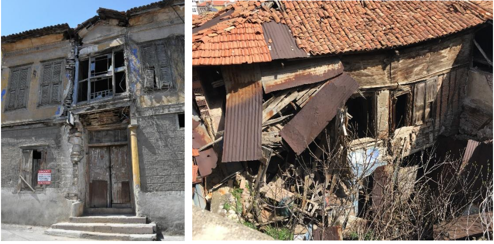
Şekil 3.12 Esaslı onarım yapılması gereken 255 Ada 4 Parseldeki tescilli yapının ön ve arka cephesi (Kişisel arşiv, 2018)
