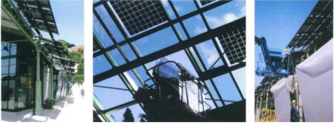
Şekil 3.10 Binanın giriş ve güney cephesindeki PV saçaklar ve çatıya yerleştirilen PV modüller (Prasad ve Snow, 2014)
