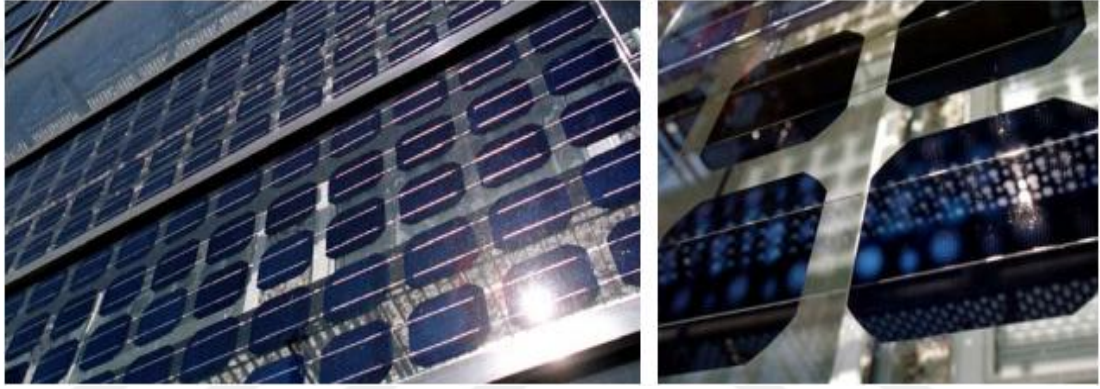
Şekil 3.17 Trondheim'daki BP Solar Skin duvarında kullanılan entegre fotovoltaik hücreleri (Basnet, 2012)
