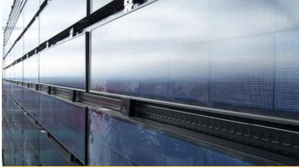
Şekil 3.14 Bina cephesine entegre güneş termal hava kollektörüne takılan özel PV modülleri ve yakından görünüşü (Concordia, 2018)
