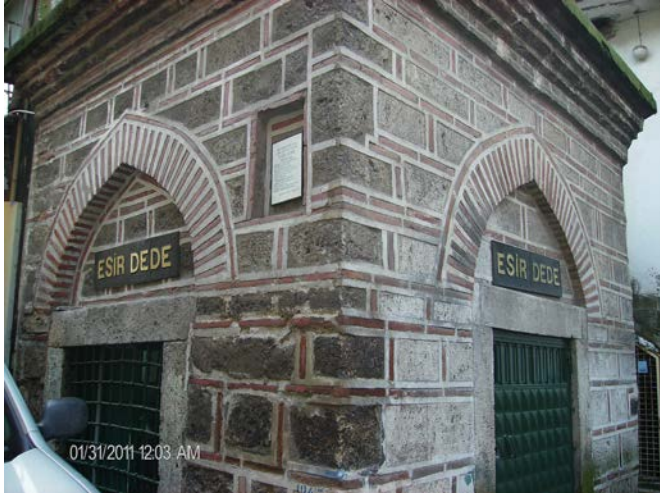
Resim 189: Esir Dede Türbesi, Pencere Atkı ve Sövesi
