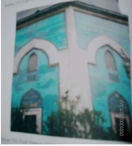
Resim 325: Yeşil Türbe, 2010 Yılı Onarımından Önce Dış Duvarlarda Çiniler
