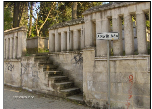
Şekil 5.106 : 8. ada duvarı kirlilik
