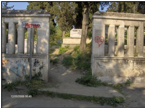
Şekil 5.105 : 10. ada duvarı kirlilik
