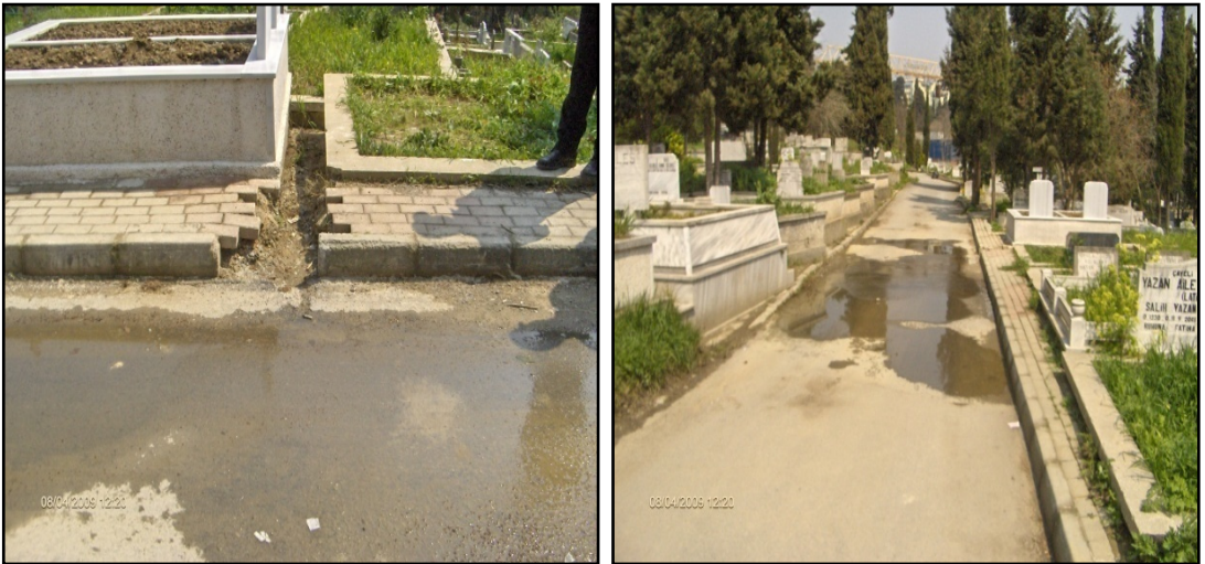
Şekil 5.177: Alt yapısı olmayan yoldaki su problemi
