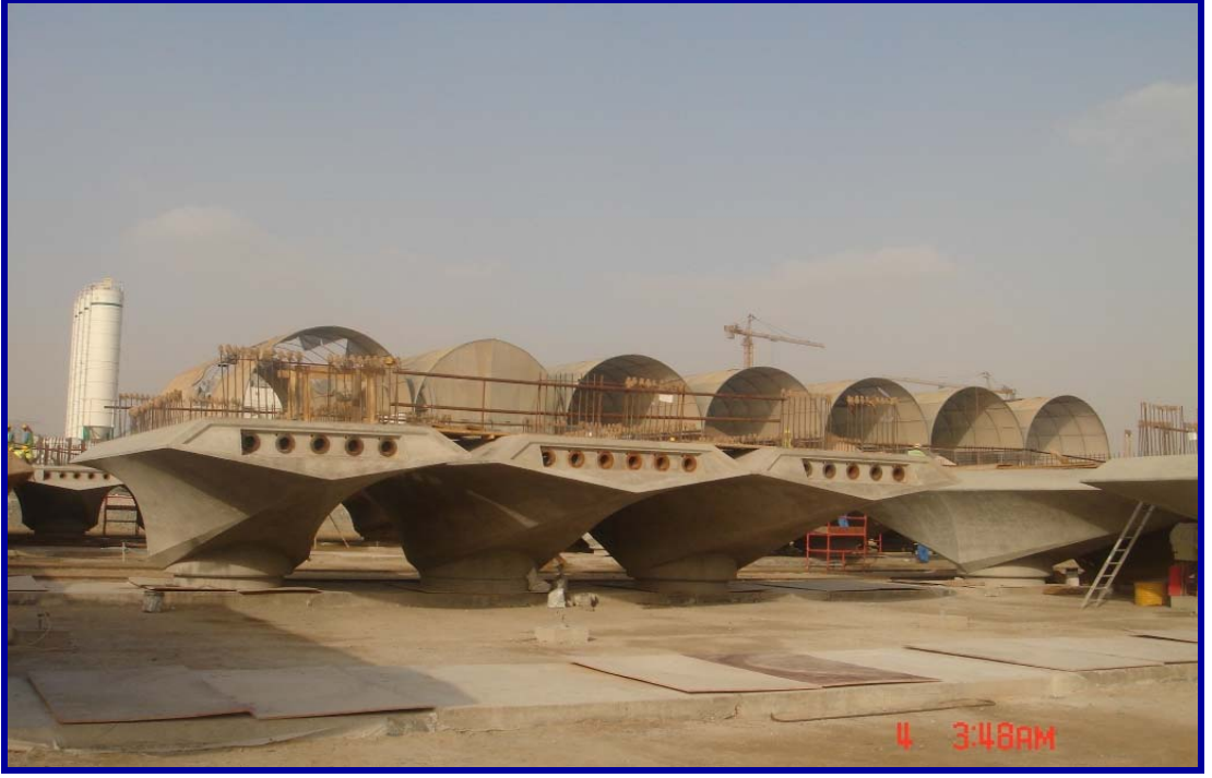
Şekil 3.5: Dubai Metro'su Viyadük Taşıyıcı Ayaklar Kaynak: İBB Raylı Sistemler Müdürlüğü Sunum Dosyası
