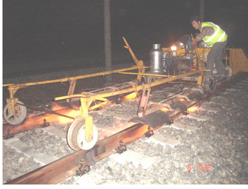
Şekil 4.2: Ray ısıtma aparatı
