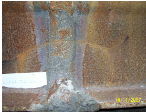
Şekil 5.2: Ray gövdesinde çatlak
