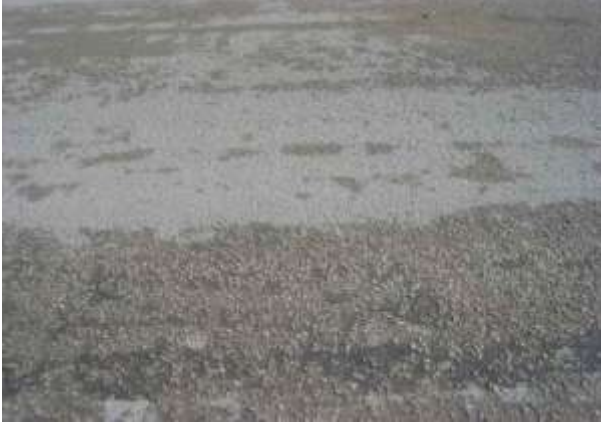
Resim 7.1 : Bir Sathi Kaplama yüzeyinde meydana gelen agrega kopmaları ve yüzeyde meydana gelen ayrışmalar
