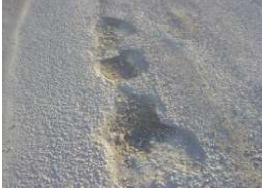
Resim 7.2 : Yüzeydeki Agrega Parçalarının Kopması
