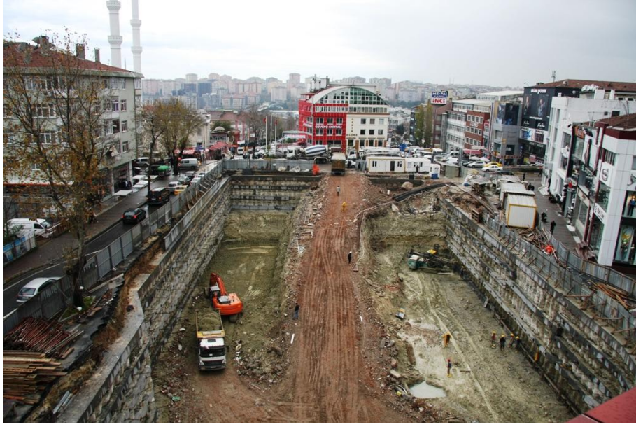
Şekil 2.91: Merter Kasım Sokak yer altı otoparkı ve park düzenleme projesi inşaatı (Temmuz 2010)
