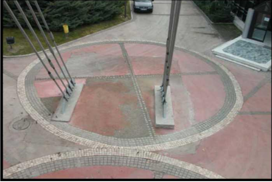
Şekil 4.17: Taşıyıcı halatlar ve yer kaplaması detay hataları
