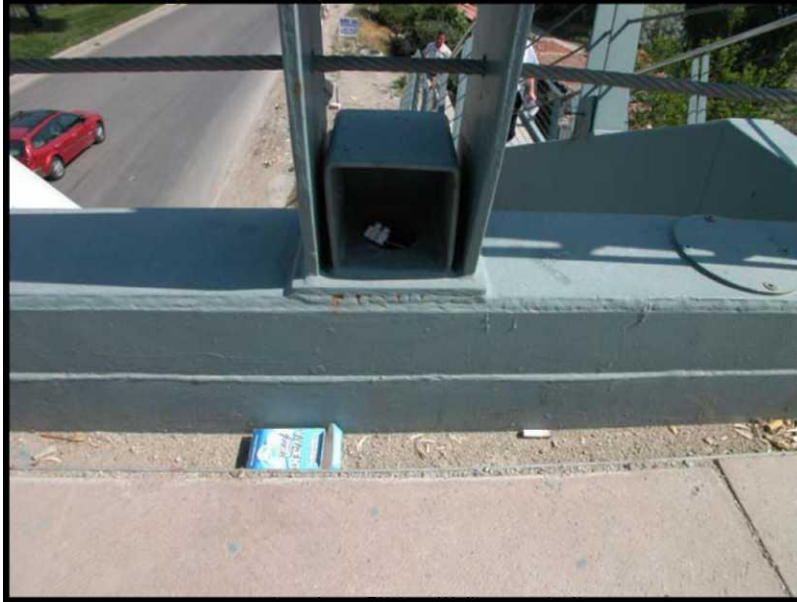
Şekil 4.20: Korkuluklarda uygulanan aydınlatma elemanlarının montajlarının tamamlanmaması
