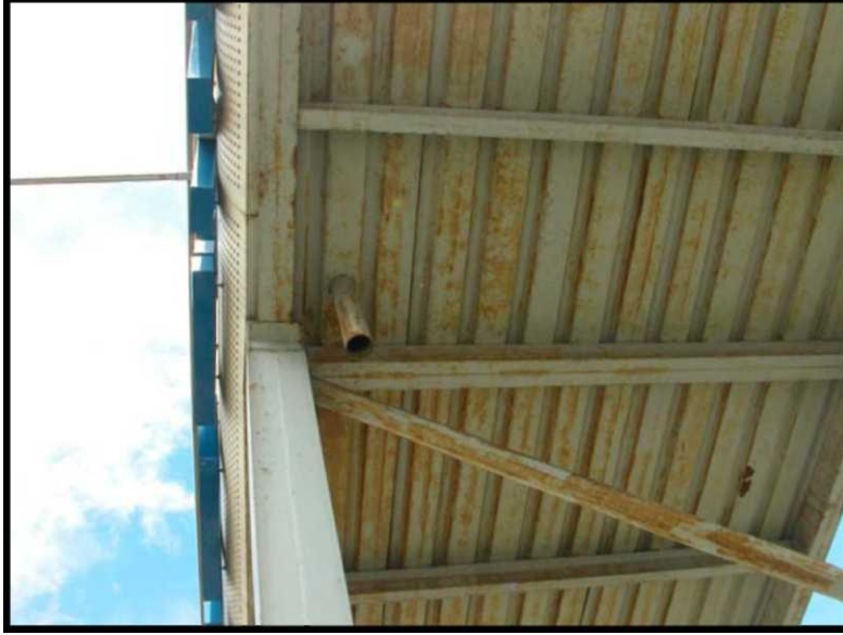
Şekil 4.22: Köprülerde oluşan yağmur gideri detay sorunları
