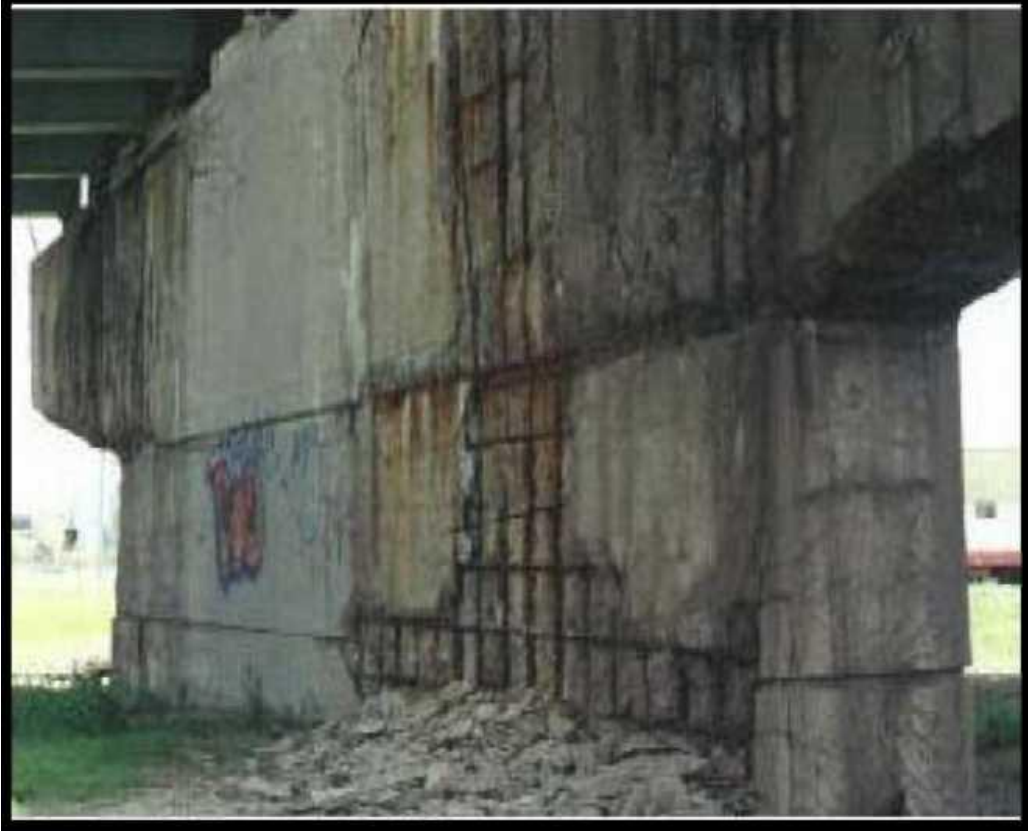
Şekil 4.9: Betonda korozyon sonucu oluşan çatlaklar
