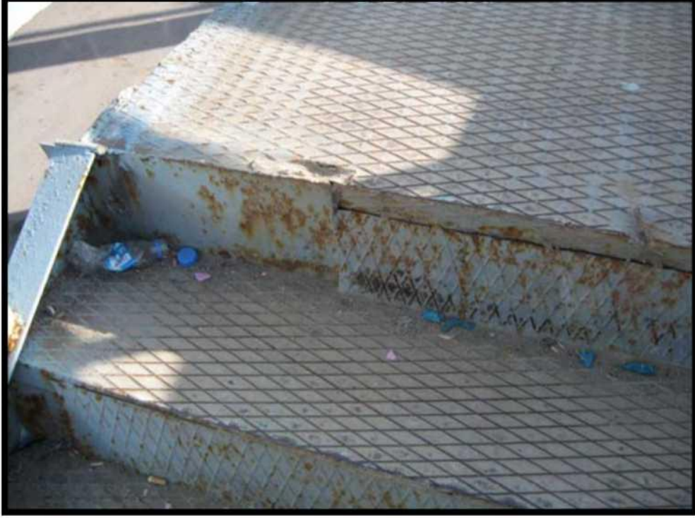
Şekil 4.15: Merdiven korkulukları ve basamakları işçilik hataları
