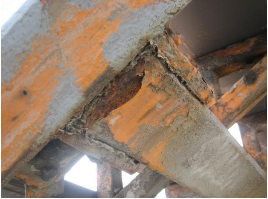
Őekil 4.10: Yaya stgeitlerinde tařıyıcı sistem noktalarındaki korozyon
