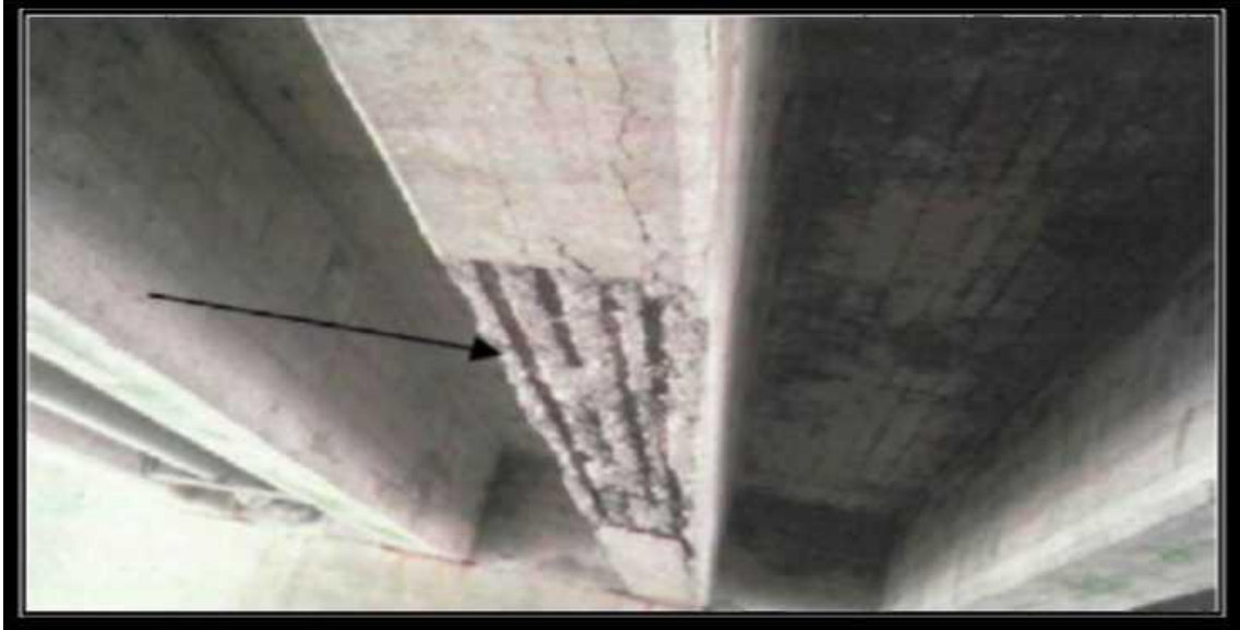
Şekil 4.1: Kirişte paspayı ve korozyon problemi
