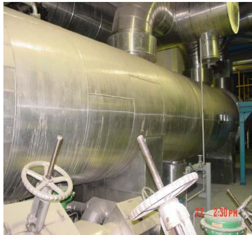
Şekil 6.7: Doğa Enerji Kojenerasyon Tesisi HT Yoğuşturucusu
