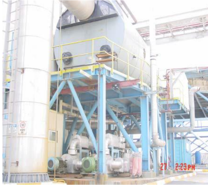
Şekil 6.8: Doğa Enerji Kojenerasyon Tesisi yardımcı kazanı
