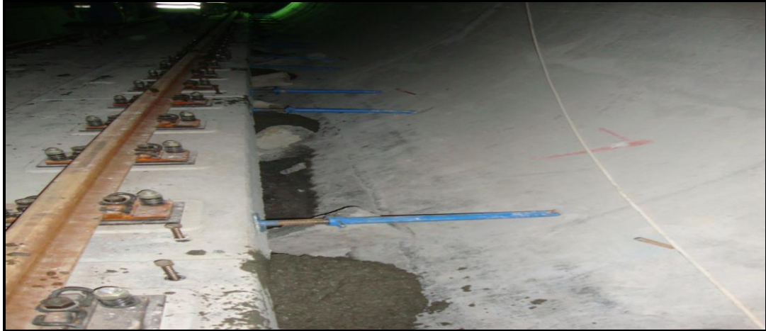
Şekil 4.23: Topuk Betonları Dökülmüş Olan Prekast Paneller
