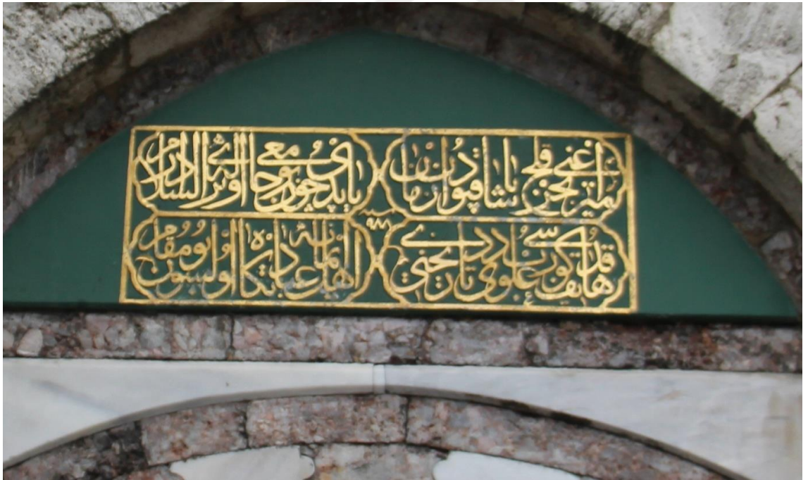
Resim 4.112. Avlu Giriş Kapısı (Kuzey)
