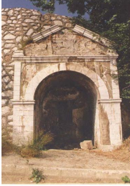
Resim 110. Hamidiye Çeşmesi Onarım Görmeden Önceki Görüntüsü (Arif Özer'den)
