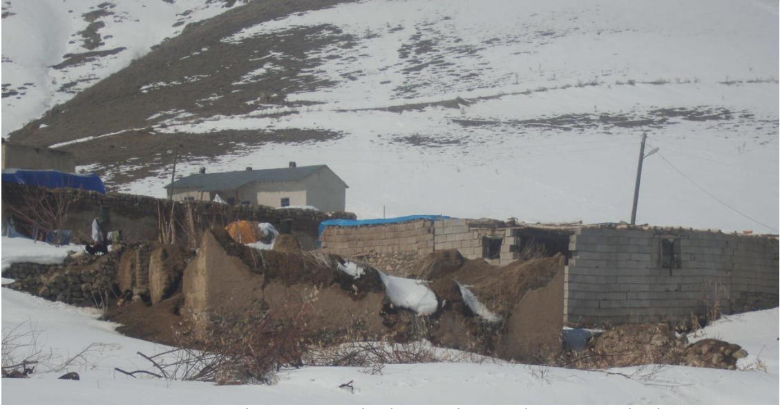
Fotoğraf 4.4. Van Ve Erciş'te 2011 Yılında Meydana Gelen Depremlerde Araştırma Sahasının Batısında Bulunan Kırsal Yerleşmelerde Zarar Gören Ev Ve Eklentiler.
