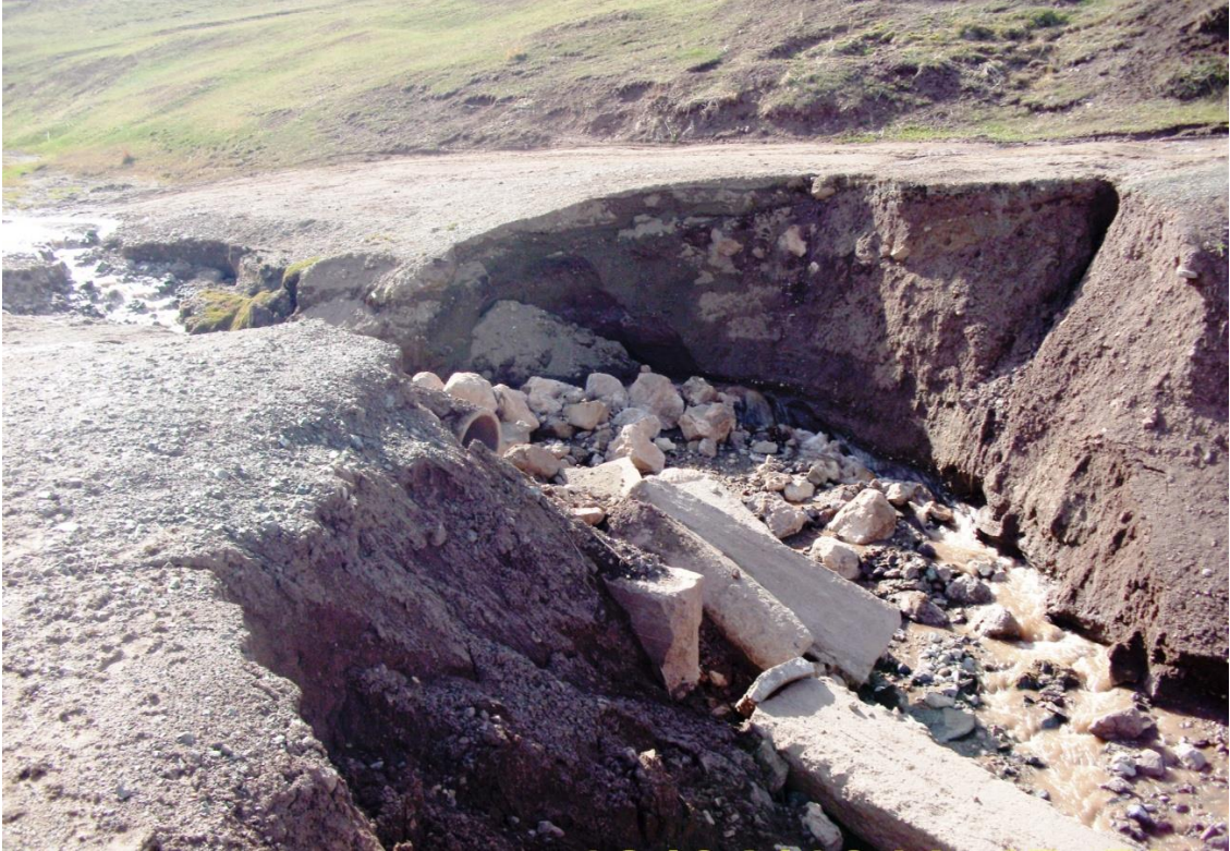
Fotoğraf 4.3. Arıtoprak ve Karlıyamaç Köyleri Arasındaki Yolda Yapılan Menfez 2011 Yılında Meydana Gelen Sel Nedeniyle Zarar Görmüştü.
