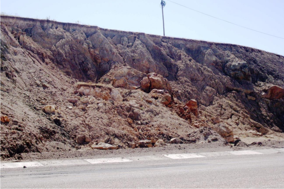
Fotoğraf 4.2. Van-Özalp Karayolunun Kenarında Yola Zarar Veren Taş ve Topraktan Bir Görünüm.
