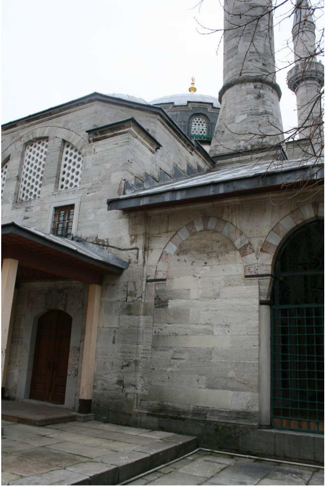
Resim 6: Son Cemaat Yeri Duvarının Öne Çıkarılması Nedeniyle Doldurulan Kemer Açıklığı.
