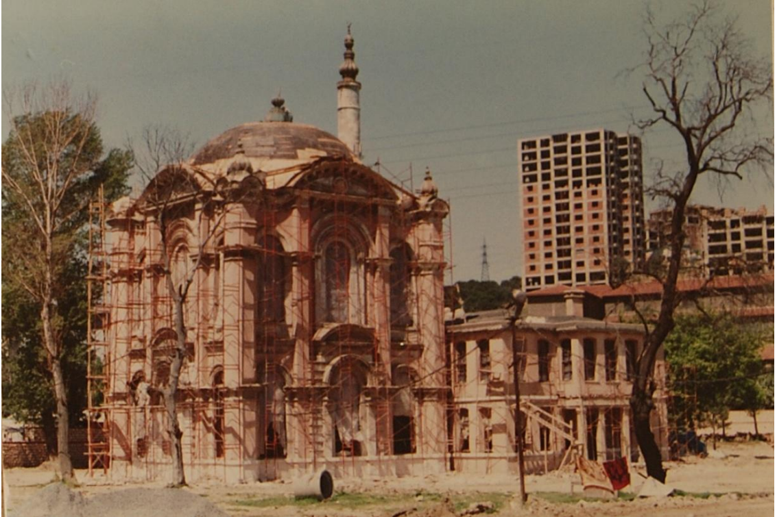
Fotoğraf 51: Haliç Sâdâbâd Camisi, 1998 yılı onarım öncesi güneydoğu cephe görünümü. (Kaynak: Şura Kavalcı Özel Arşivi)
