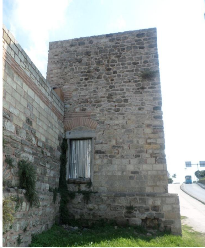
Fotoğraf 161: Topkapı ile Vatan Caddesi Arasındaki Ön Sur Duvarı Üzerinde Yer Alan Kare Burcun Sol Cephesi
