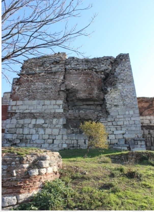
Fotoğraf 221: Edirnekapı ile Fevzi Paşa Caddesi Arasındaki Sur Hattında Yer Alan Burcun Ön Cephesi
