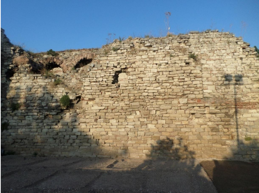
Fotoğraf 44: Yedikule Kapı ile Belgrad Kapı Arasında Yer Alan Ön Sur Duvarı
