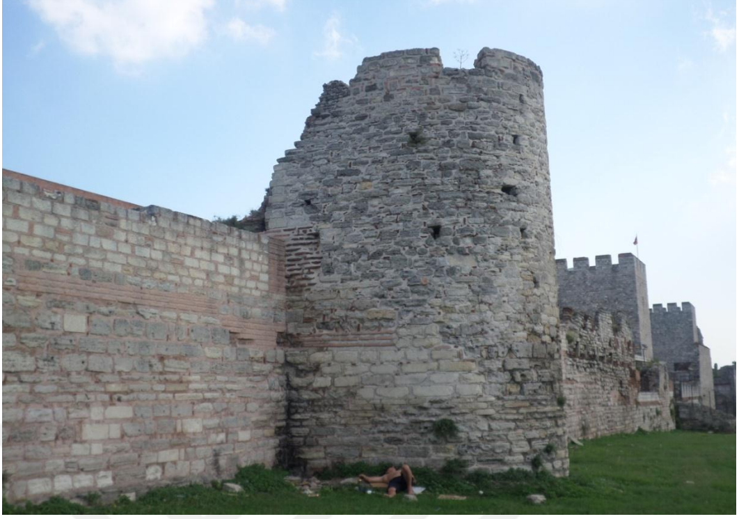
Fotoğraf 143: Millet Caddesi ile Topkapı Arasındaki Ön Sur Duvarında Yer Alan Silindirik Burcun Sol Cephesi
