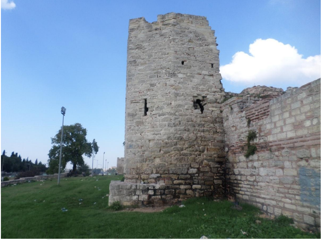
Fotoğraf 145: Millet Caddesi ile Topkapı Arasındaki Ön Sur Duvarında Yer Alan Kaideli Çokgen Burcun Sağ Cephesi
