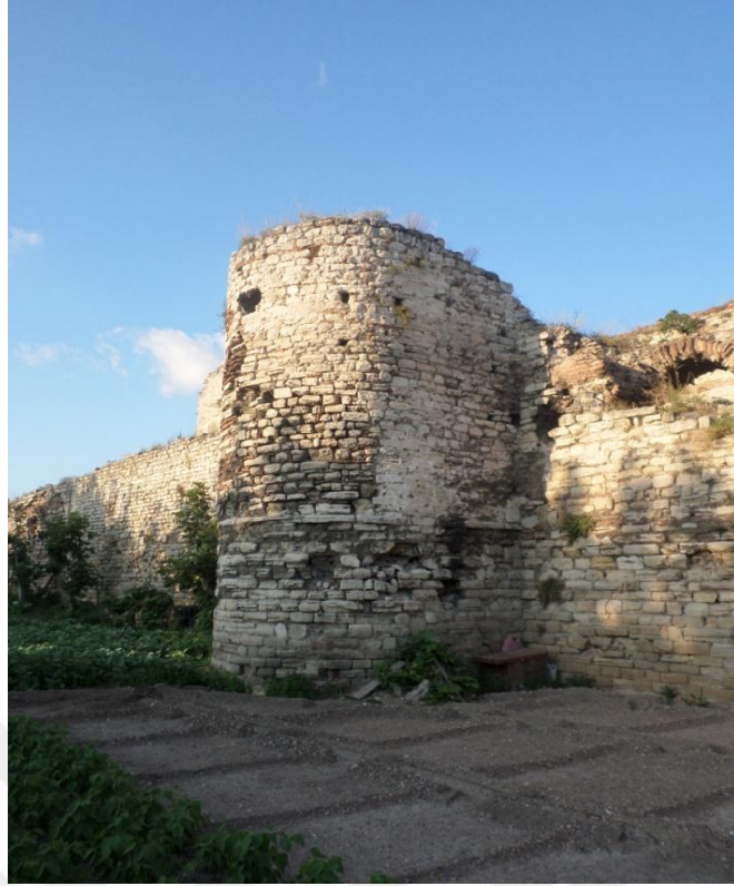
Fotoğraf 45: Yedikule Kapı ile Belgrad Kapı Arasında Yer Alan Ön Sur Duvarı Üzerindeki Silindirik Burcun sağ Cephesi Fotoğraf
