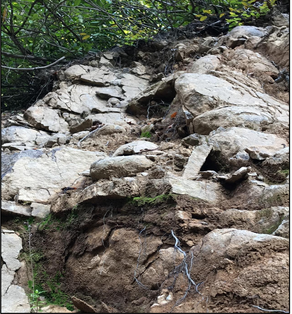
Fotoğraf 14. Dikey ve yatay çatlaklarda gelişen gürgen kökleri. Hornbeam roots developing in vertical and horizontal cracks.
